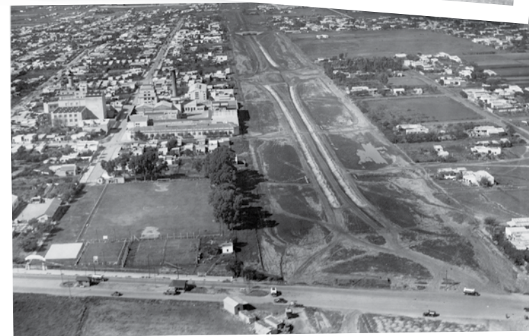
Vista de la General Paz en obra, desde Liniers hacia el Riachuelo
